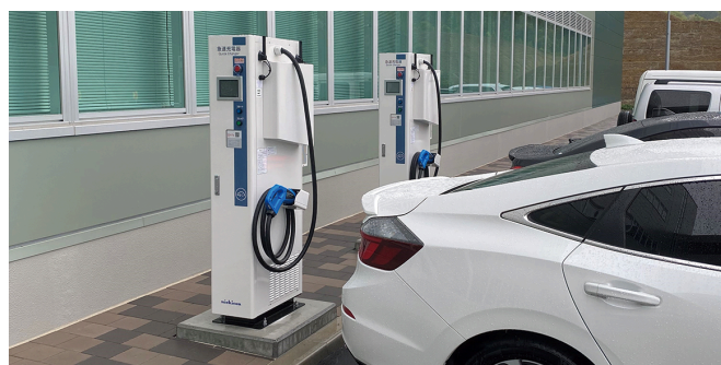
EV用充電設備
