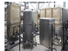
地下水浄化システム
