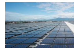
太陽光発電システムの導入
