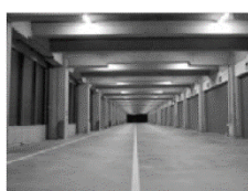
館内照明器具をLED化し、温室効果ガス排出量の削減を実現
