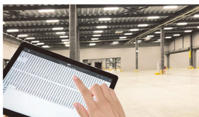
センサー付LED照明の導入
