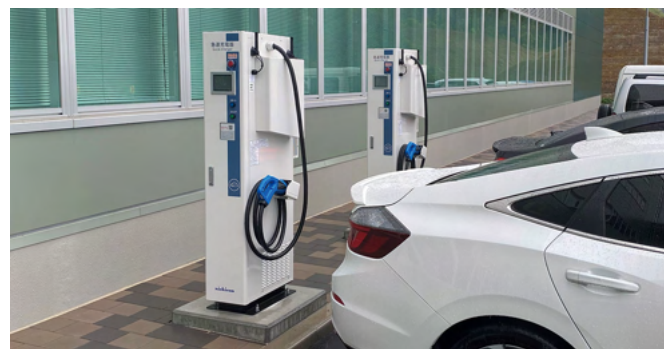
EV用充電設備
