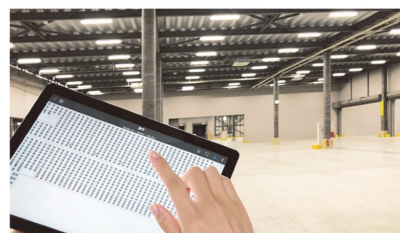
センサー付LED照明の導入
